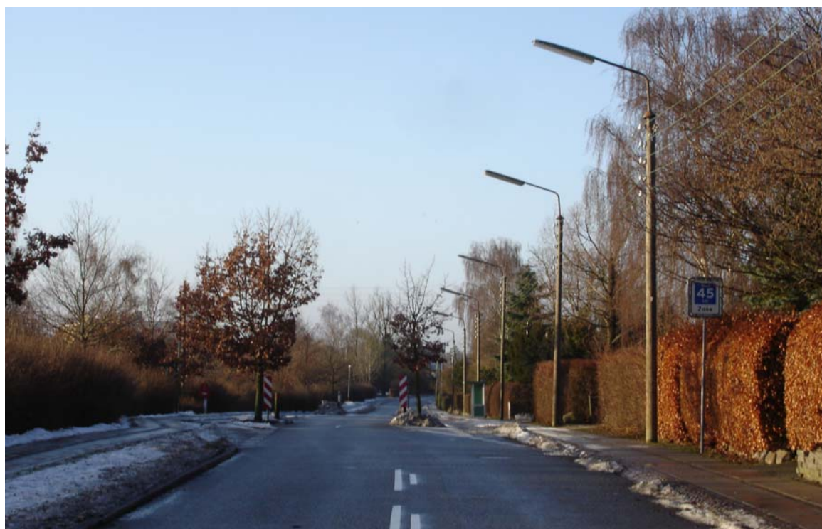
Eksisterende belysningsanlæg med lysrørsarmaturer.
