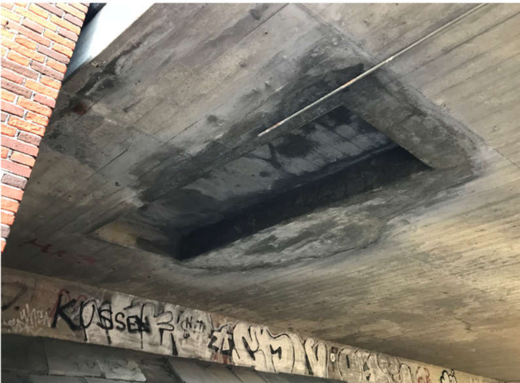
Figur A-5 - Udsparring i brodæk i umiddelbar nærhed til trappen ved Centrumgaden, nord for banen
