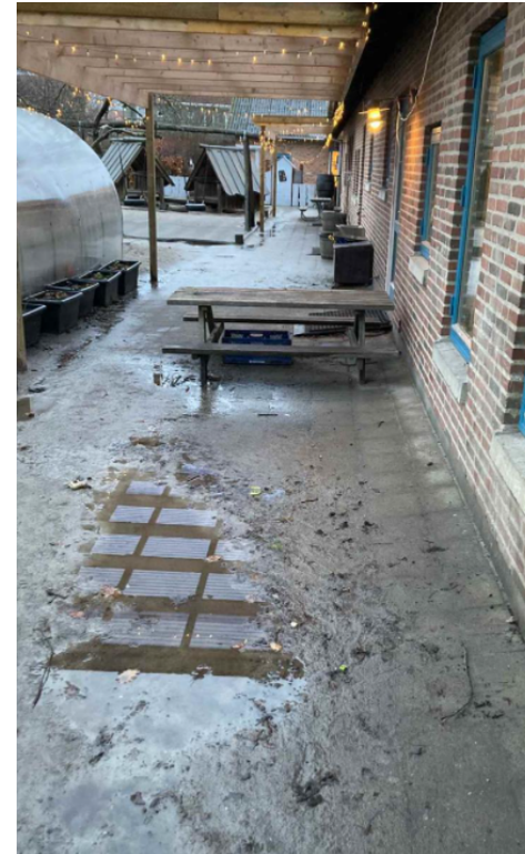
Egebjergvang 72-74, Rep af lunker i belægningen.
